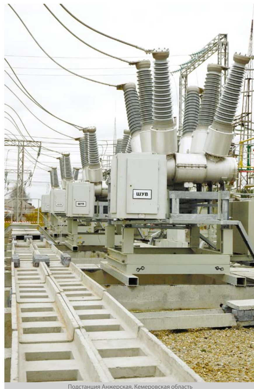
Подстанция Анжерская, Кемеровская область
