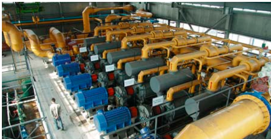
В начале августа прошлого года СУЭК построила мини-теплоэлектростанцию на шахте им. Кирова в Ленинске-Кузнецком, которая использует в качестве топлива метан, собираемый на шахте установками дегазации
