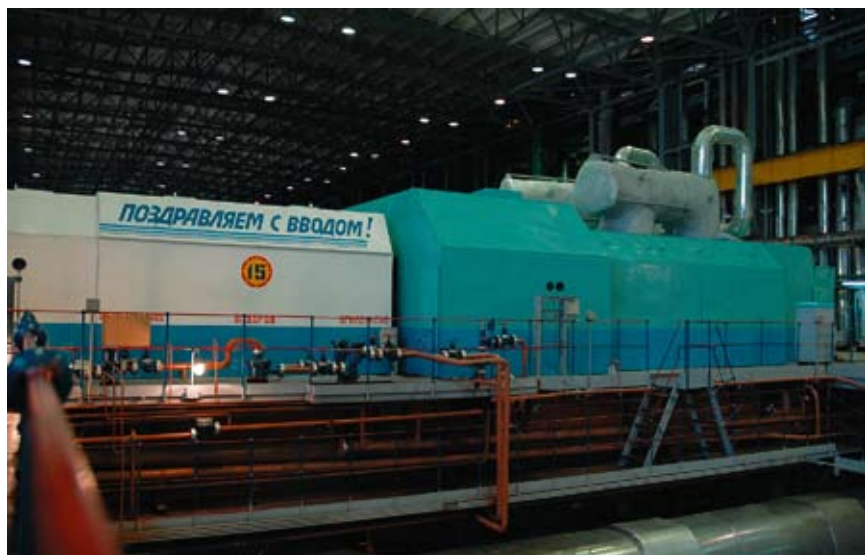
Первым крупным вводом уходящего 2009 года стал пуск нового турбогенератора на Ново-Кемеровской ТЭЦ в составе ОАО «Кузбассэнерго»
